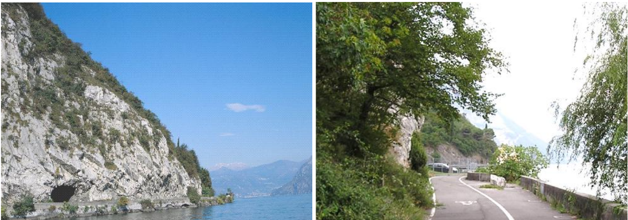
Corno di Predore: fronte roccioso soggetto a stacco di blocchi e masso caduto sul tratto di strada litoranea ora dismessa
